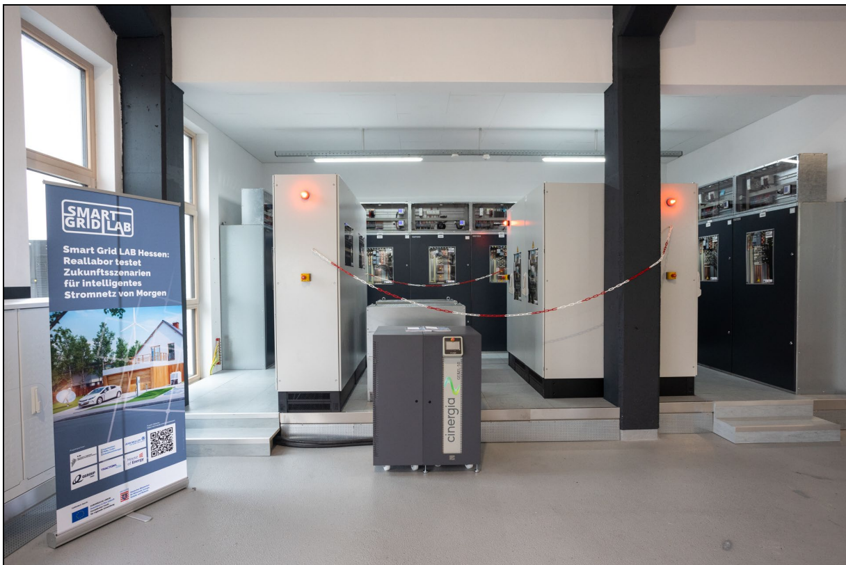
Abbildung 26: fertiges Smart Grid LAB Hessen.
